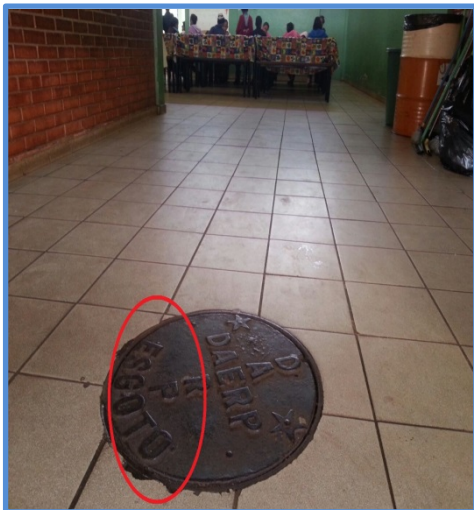
EE Profº Baudílio Biagi Município: Riberão Preto QUANDO CHOVE TRANSBORDA O ESGOTO NA COZINHA.
