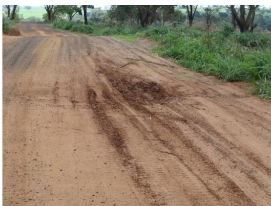
Foto 7: Formação de atoleiro devido ao escoamento de água no leito da via (VTG-287 - Votuporanga)
