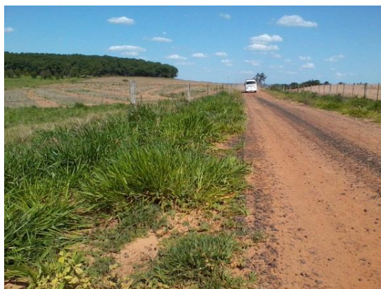
Foto 26: Falta de roçamento nas laterais da via (AVM-482 - Álvares Machado)
