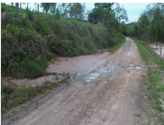
Foto 15: Drenagem inadequada (AHB-164 - Anhembi)
