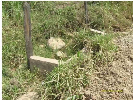
Foto 24: Caixa de contenção de águas entupida (SLR-146/080 - Salto de Pirapora)
