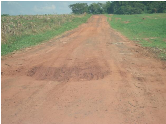
Foto 11: Buracos na pista (MGD-122 - Magda)
