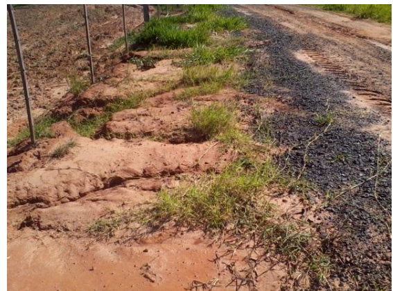
Foto 4: Formação de erosão na lateral da estrada (AVM-482 - Álvares Machado)
