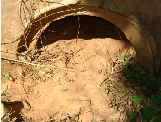
Foto 17: Duto entupido (GAI-050/440 - Guaraçai)
