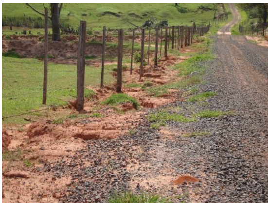
Foto 3: Formação de erosão na lateral da estrada (PZH-428 - Pirapozinho)
