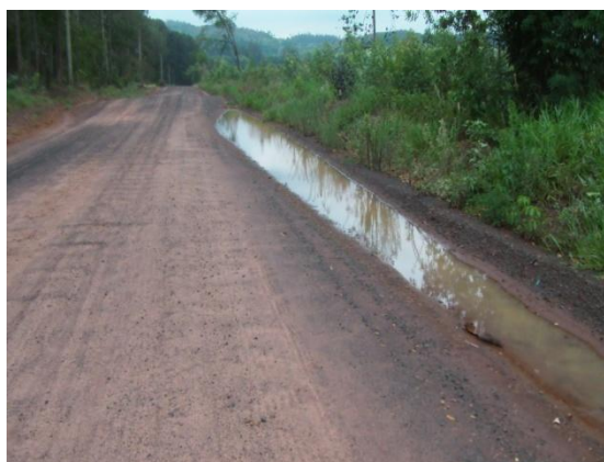
Foto 16: Drenagem inadequada (PFR-339/010 - Porto Ferreira)
