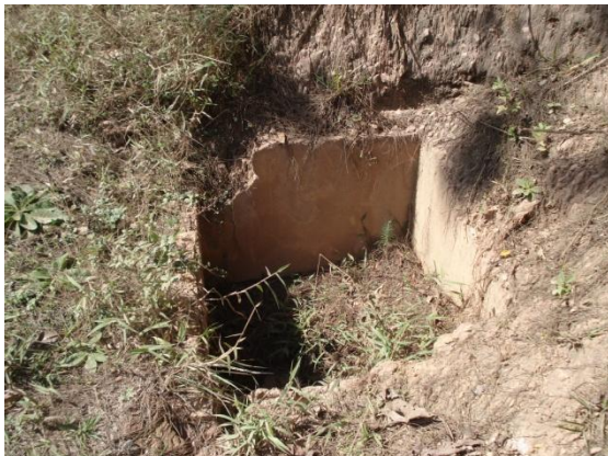
Foto 23: Caixa de contenção de águas entupida (Bairro das Marrecas - Juquitiba)
