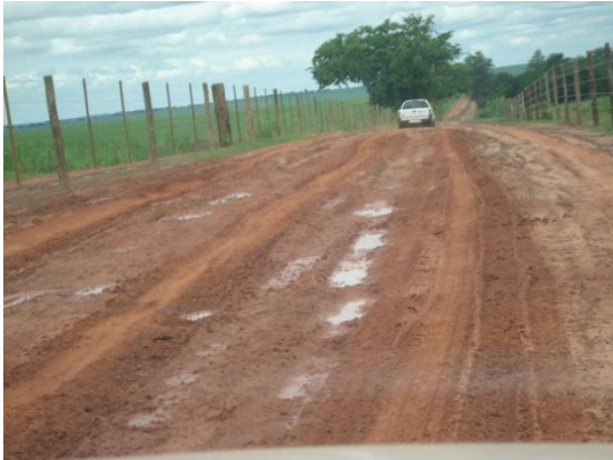
Foto 31: Grande quantidade de buracos e atoleiros na pista (LIN-449 - Lins)
