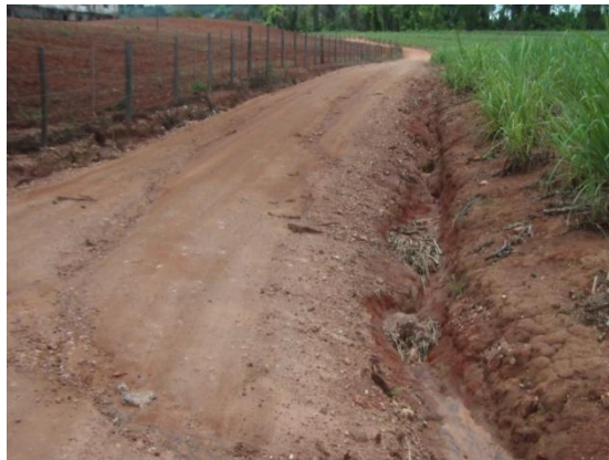
Foto 12: Buracos na pista (VGS-015/08 - Vargem Grande do Sul)
