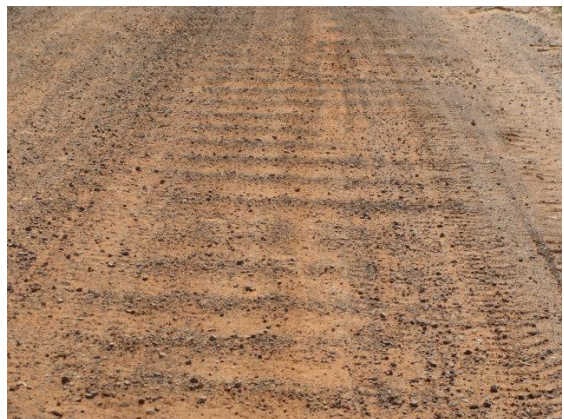
Foto 20: Ondulações na pista (VTG-287 - Votuporanga)
