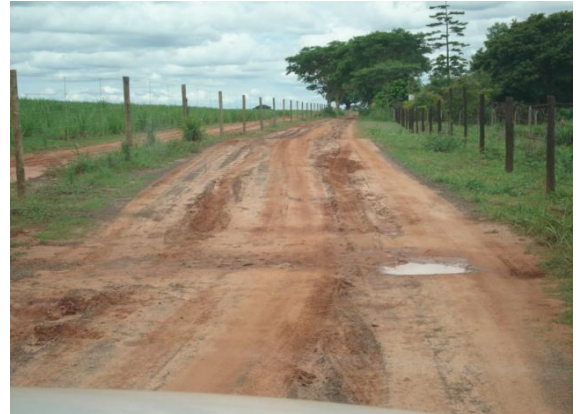
Foto 32: Grande quantidade de buracos e atoleiros na pista (LIN-449 - Lins)
