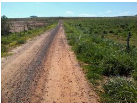
Foto 25: Falta de roçamento nas laterais da via (AVM-482 - Álvares Machado)
