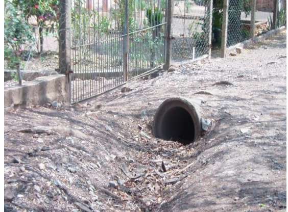
Foto 18: Duto entupido (RCL-314 - Rio Claro)
