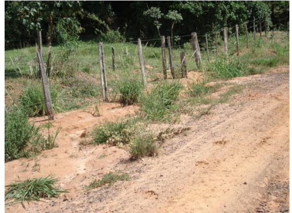
Foto 28: Falta de roçamento na lateral da estrada ocasionando processos erosivos (ART-349 - Araçatuba)
