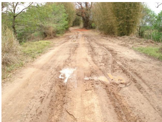
Foto 5: Formação de atoleiro devido ao escoamento de água no leito da via (AVC-325 - Álvaro de Carvalho)
