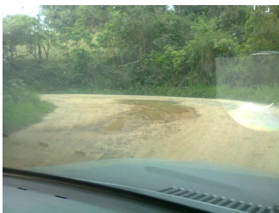
Foto 8: Formação de atoleiro devido ao escoamento de água no leito da via (Dr. Hamilkar Bevilaqua - B. Bela Aurora ou Faz. Da Cascata - Queluz)
