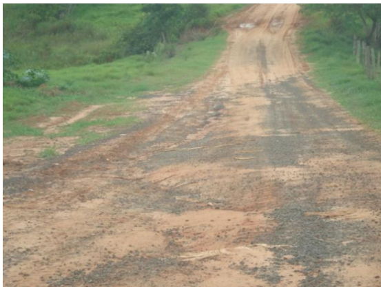
Foto 29: Pista de rolamento bastante irregular, com muitos buracos (LIN-225 - Lins)
