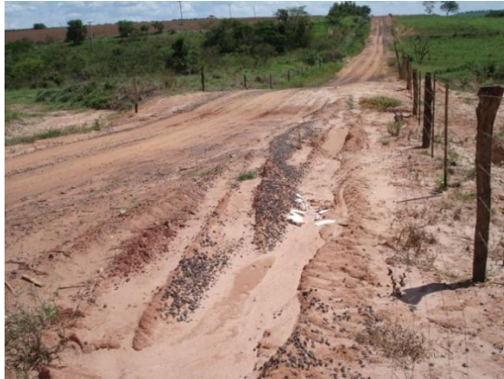
Foto 27: Problemas com drenagem causam a formação de atoleiros, afundamento do leito da pista e processos erosivos (ART-349 - Araçatuba)
