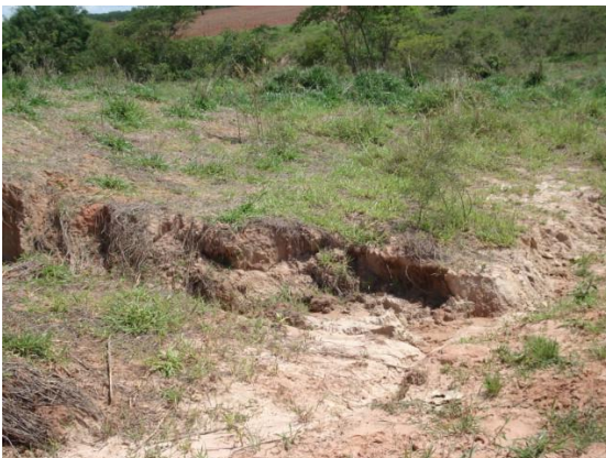
Foto 21: Caixa de contenção rompida (ART-349 - Araçatuba)
