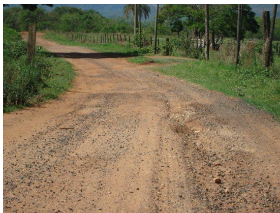
Foto 14: Buracos na pista (RFN-020 - Rifaina)
