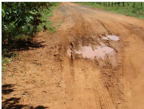
Foto 6: Formação de atoleiro devido ao escoamento de água no leito da via (FND-070 - Fernandópolis)
