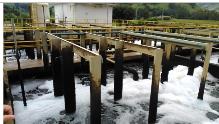
Foto 3.1.3.5 - Tanque de tratamento de esgoto na ETE São Bento do Sapucaí
