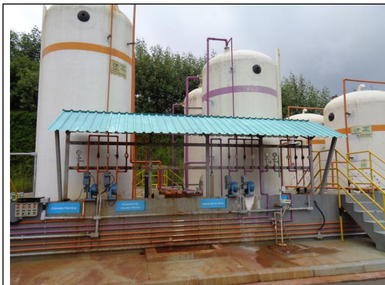
Foto 3.1.3.2 - Reservatórios de produtos químicos da ETE de Campos do Jordão
