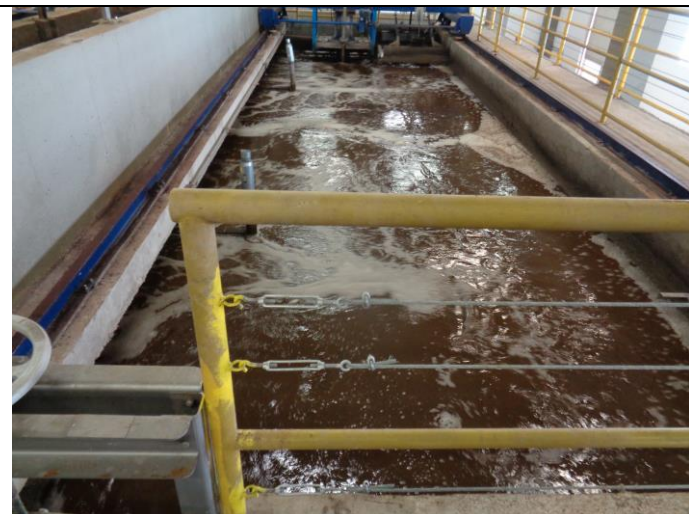
Foto 3.1.3.3 - Tanque de tratamento preliminar do esgoto na ETE de Campos do Jordão
