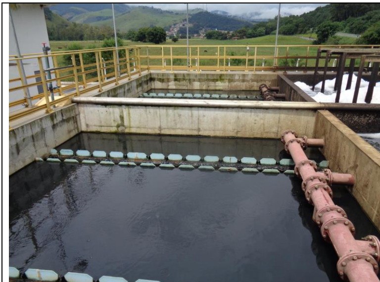
Foto 3.1.3.6 - Tanque de tratamento de esgoto na ETE São Bento do Sapucaí
